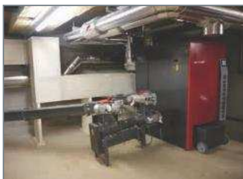
Chaudière de 200 kW avec 2 vis entrée chaudière
