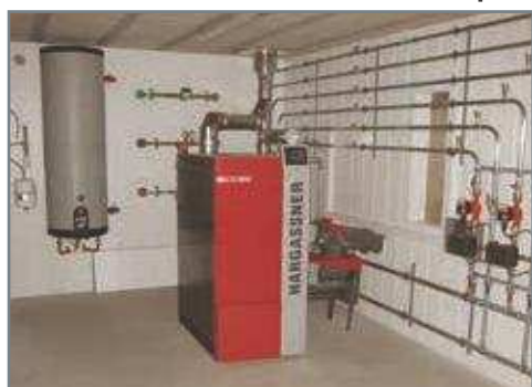
Chaudière EcoHK de 35 kW avec Production d'ECS
