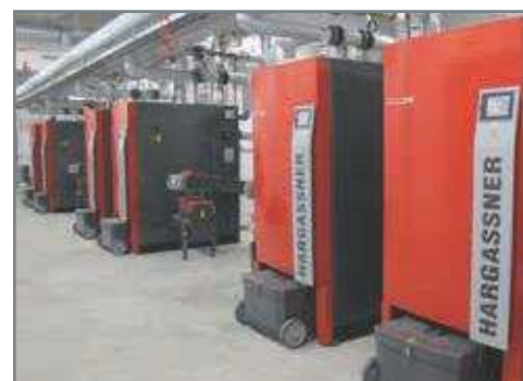
Cascade de 6 chaudières de 200 kW
